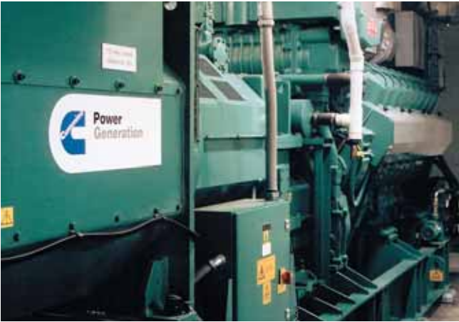
Le groupe électrogène à mélange faible de Cummins Power Generation produit jusqu'à 1,75 MW d'électricité et 1 800 kilogrammes de vapeur par heure dans une application CCE.
