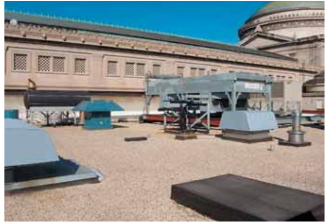
Le radiateur et le silencieux d'échappement du moteur à mélange pauvre sont installés sur le toit.
