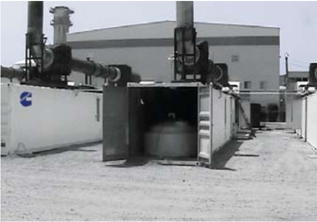
Chaque unité comprend un réservoir de 600 gallons pour le système d'injection d'urée qui contrôle les oxydes d'azote.
