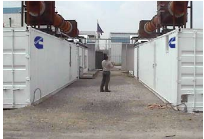
Les caissons des générateurs possèdent des pots d'échappement améliorés et une isolation acoustique pour réduire le bruit.
