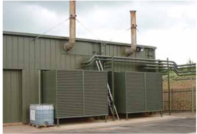
Le conduit sortant du bâtiment électrique contient la ligne de transmission de 11 kV qui alimente la cimenterie.
