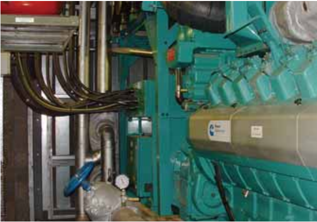
Le site possède deux groupes électrogènes de modèle 1750 GQNA à faibles Btu conçus pour fonctionner avec du méthane dilué.
