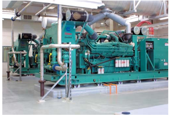
Le système de secours de Cummins Power Generation inclut un groupe électrogène de 350 kW et deux de 1 500 kW.
