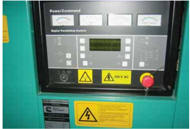
La commande centrale numérique PowerCommand assure une bonne transition du secteur au générateur.
