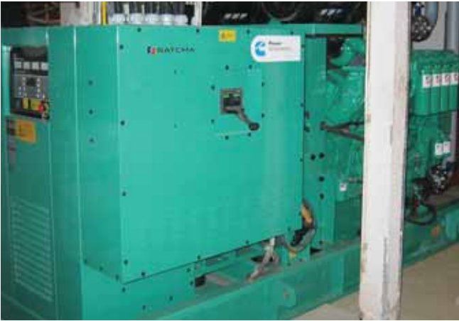
Un nouveau générateur de secours de 819 kVA (713 kW) de Cummins Power Generation alimente l'extension la plus récente de l'hôpital.
