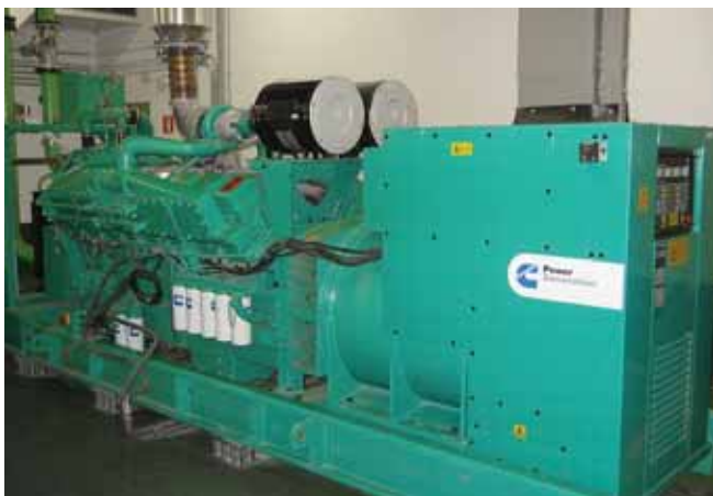
L'un des deux groupes électrogènes 1,4 MVA C1400D5 qui fournissent l'alimentation de secours pour El Corte Ingles à la galerie marchande Hipercor Xanadu.
