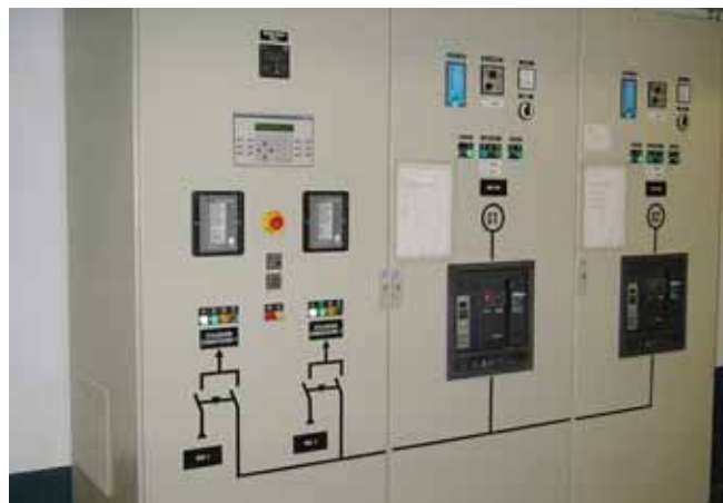
Le dispositif de commande de Cummins Power Generation permet un contrôle essentiel pendant les coupures d'électricité ou les tests mensuels.
