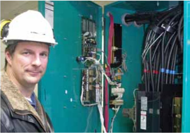
Pierre Frechet d'Hydro Sherbrooke en train de contrôler le nouveau commutateur de transfert sans coupure.
