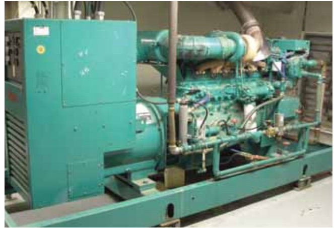
Un générateur de secours 300 kW Cummins Power Generation fournit une alimentation pour les pompes pendant les pannes de courant du réseau public et pendant les périodes de demande de pointe.
