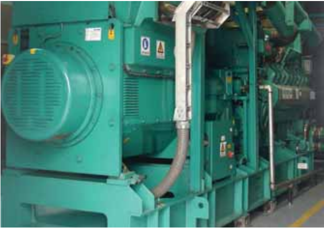
Le cœur du système de cogénération est un groupe électrogène à moteur à gaz de 1 750 kW de Cummins Power Generation.
