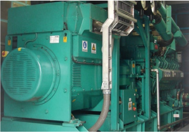
El núcleo del sistema de cogeneración es un grupo electrógeno de motor de gas de 1750 kW de Cummins Power Generation.
