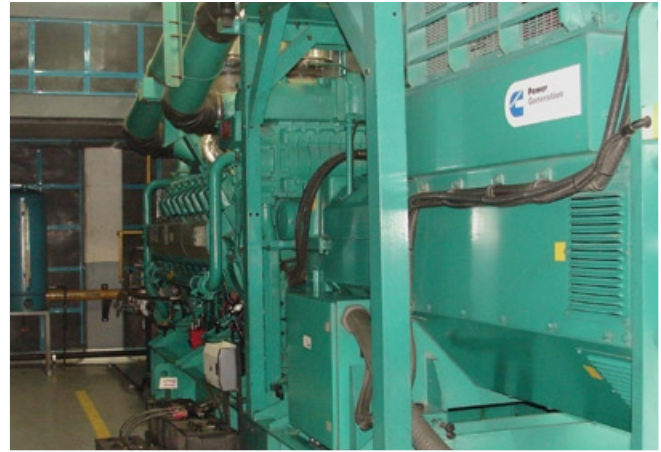
Al obtener tanto electricidad como calor del gas natural, la compañía gasta menos en energía que antes de instalar el sistema CHP, al mismo tiempo que resuelve los problemas de estabilidad del voltaje y reduce las emisiones totales.
