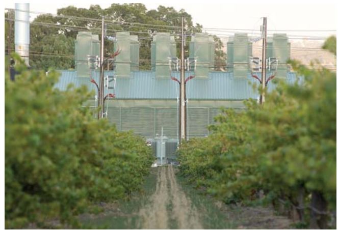
Los 30 conjuntos generadores QSK60 de Cummins Power Generation de la planta pueden ponerse en marcha, sincronizarse y estar en línea generando 50 MW de energía en menos de dos minutos.
