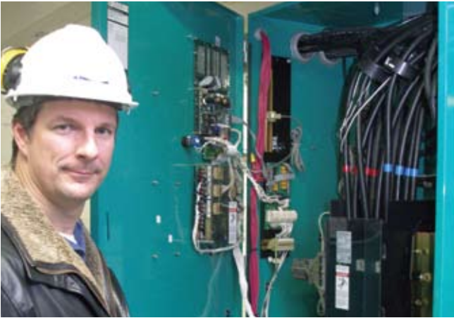
Pierre Frechet, de Hydro Sherbrooke, inspecciona el nuevo interruptor de transferencia de transmisión cerrada.
