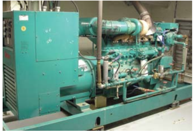
Un generador de reserva de 300 kW de Cummins Power Generation proporciona energía a las bombas durante fallas en la red local y periodos de máxima demanda.
