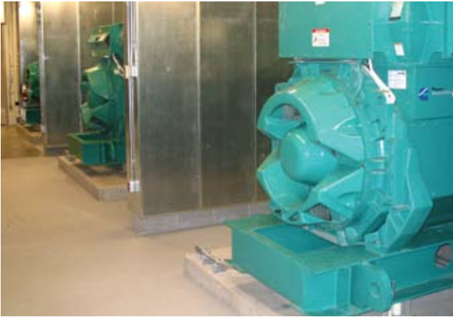
Tres conjuntos generadores diésel de 2 MW de Cummins Power Generation proporcionan energía de reserva al Alberta Children's Hospital.
