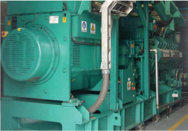
El componente principal del sistema de cogeneración es un conjunto generador con motor a gas de 1.750 kW, de Cummins Power Generation.
