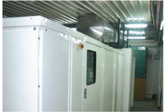
Los generadores del sótano están dentro de recintos insonorizados para limitar las emisiones de ruido.
