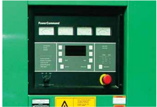
El control PowerCommand avanzado de Cummins Power Generation garantiza un rápido inicio para alimentar la carga de 2000 kVA.
