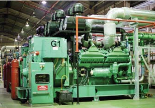
Cummins Power Generation instaló los generadores como un proyecto llave en mano, que incluía la totalidad de las instalaciones eléctricas y mecánicas.
