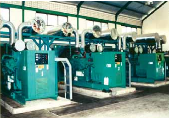
Los conjuntos generadores de alta capacidad de Cummins Power Generation complementan el suministro de energía de PLN en Bontang.
