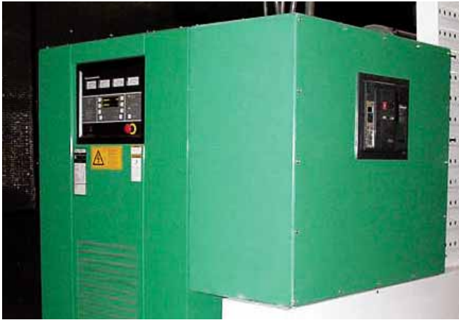
La variedad de conjuntos generadores de Cummins Power Generation proporciona energía de reserva fiable a la cadena Tesco Lotus.
