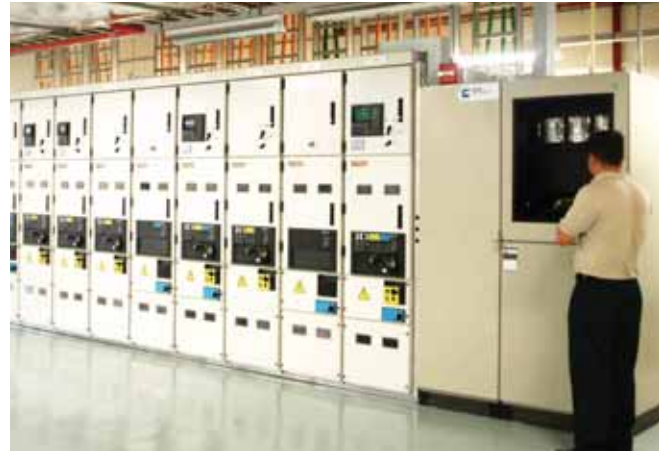
Los avanzados controles PowerCommand y ATS de Cummins Power Generation garantizan un cambio de carga en 20 segundos.
