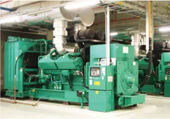
Sistema generador de alto voltaje de Cummins Power Generation instalado en UMCi.
