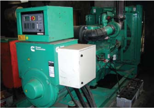
Conjunto generador C550 D5 instalado y listo para uso en paralelo con la turbina de vapor.
