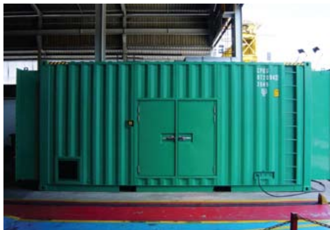
Conjuntos generadores Cummins Power Generation C1500 D6 con motores KTA50-G9.
