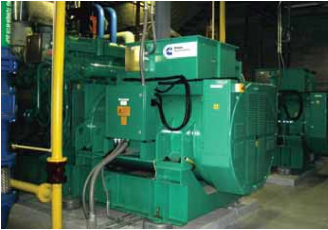
El centro del sistema de cogeneración consiste en un par de conjuntos generadores de gas de 1,25 MW de Cummins Power Generation.
