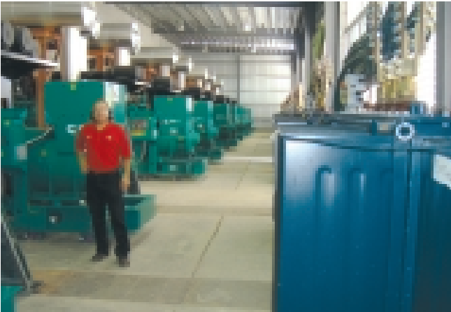
Instalación de nueve grupos electrógenos C2000 D6
