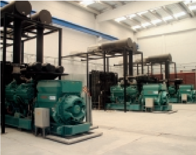
Los grupos electrógenos C2500 D5A suministran 6 MW de potencia de emergencia
