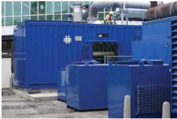
Le Frimley Park Hospital a mis en place un projet de trigénération pour réduire son empreinte carbone, grâce à un groupe de cogénération de Cummins Power Generation
