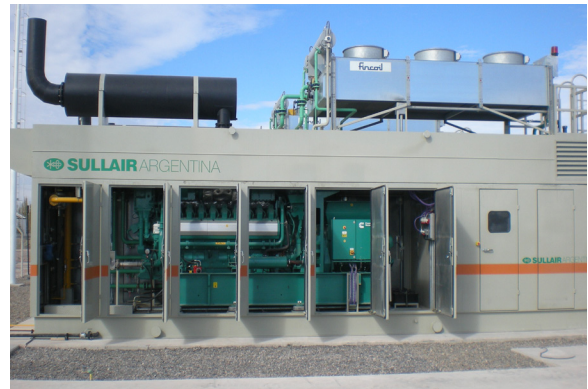
Grupos electrógenos a gas instalados por Sullair Argentina proveen energía para las operaciones internas de la empresa Pluspetrol S.A.
