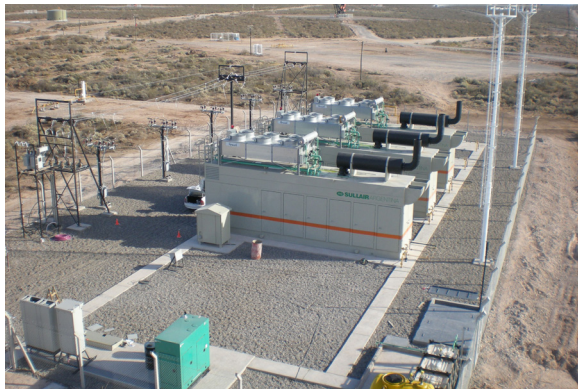
Las instalaciones energéticas del yacimiento Centenario cuentan con 10 grupos electrógenos a gas de Cummins Power Generation.
