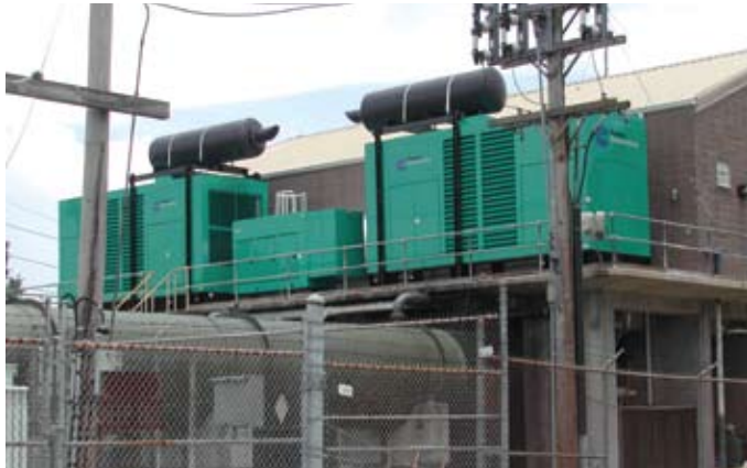
Tres generadores Cummins Power Generation estaban colocados en la estación de bombeo del canal Jefferson Parish por encima del nivel más alto de agua y continuaron funcionando mientras tuvieron combustible.
