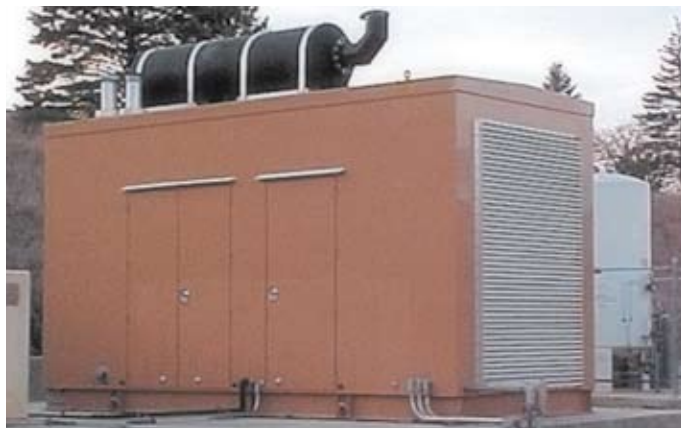
Este entorno apretado para generadores en un hospital de Audubon, Iowa, presenta paneles de acceso para facilidad de mantenimiento y un silenciador de escape residencial para disminuir el ruido del generador.
