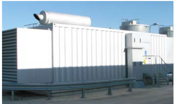
Un entorno transitable en un hospital regional de Swidon, Inglaterra, aloja un nuevo generador instalado cuando el hospital se amplió.
